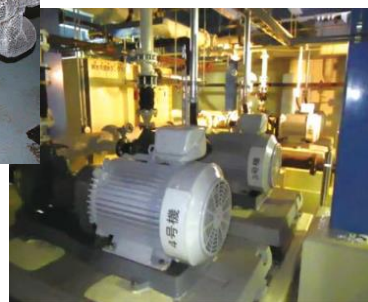
④純水系設備冷却水 ポンプとインバータ
