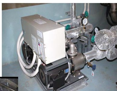
③ボイラー給水用ポンプ
