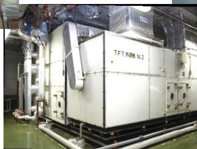
②冷水排熱利用の熱交換器
